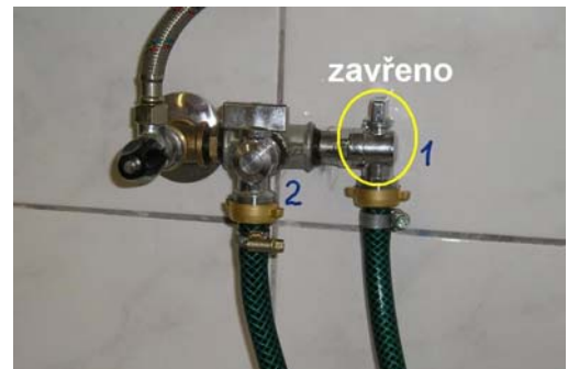
Obr. 29 Kohout uzavěru vody
